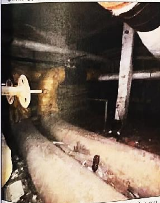
Фото 25 Транзитные трубопроводы на пристройки, расположенные под 8 подъездом
