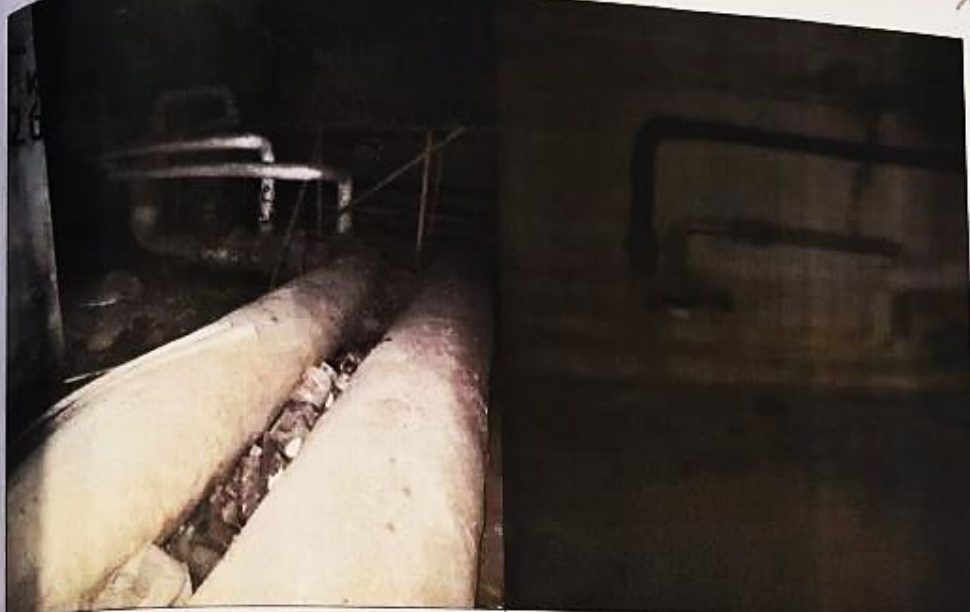
Фото 27 Транзитные трубопроводы на пристройки, расположенные под 9 подъездом
