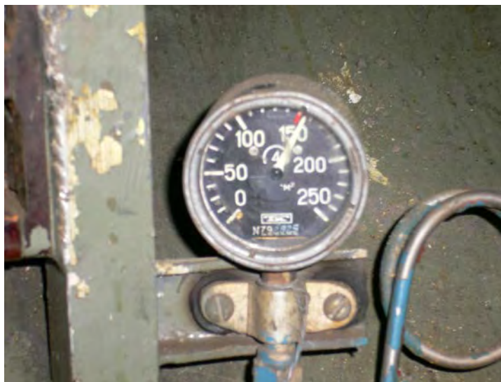
Рисунок 5.28 – Контрольный манометр давления воздуха в баллонах системы воздушного пуска двигателя
