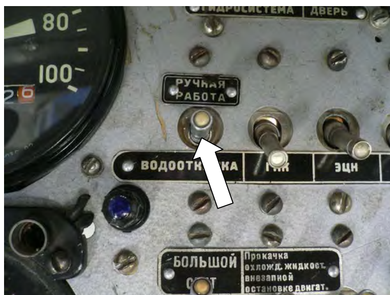
Рисунок 4.33 – Переключатель рода работы водооткачивающих насосов
