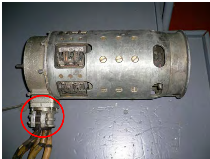
Рисунок 5.5 – Очистка наружных поверхностей агрегатов и приборов электрооборудования от пыли, грязи и масла, проверка креплений проводов
