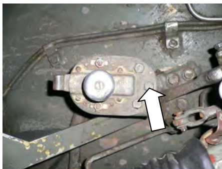
Рисунок 5.31 – Крепление выключателя аккумуляторной батареи
